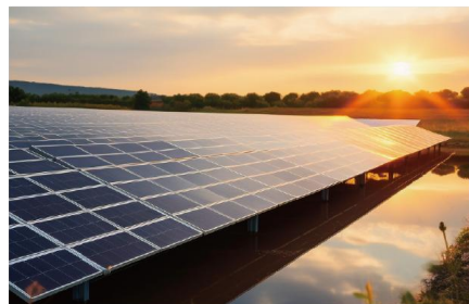
沙河市光伏发电 500MWp 项目
